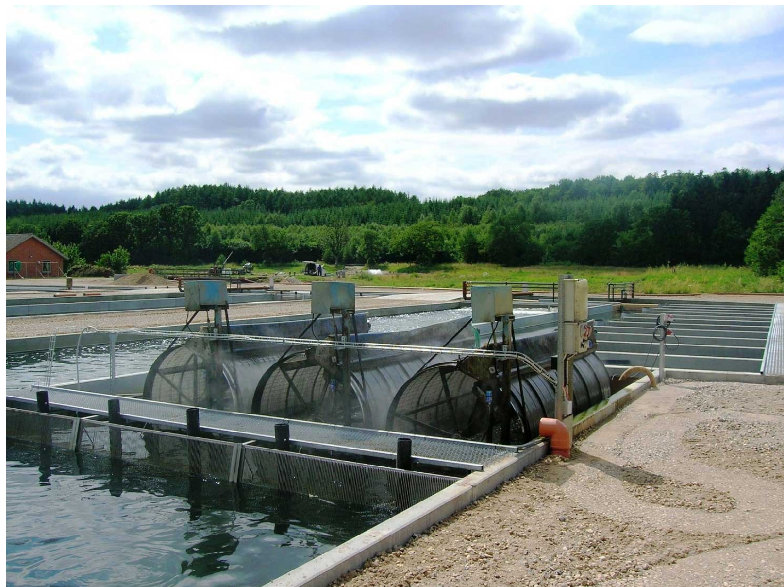
Mikrosigter på Løjstrup modeldambrug type 3. De er placeret umiddelbart opstrøms biofilterenheden. Foto: Lisbeth J. Plesner.
