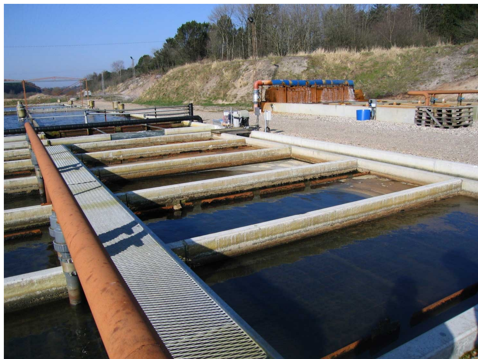
Biofilter med bioblokke opdelt i sektioner på Ejstrupholm modeldambrug type 3. Til højre for biofiltret ses et okkeranlæg, hvor der sker en iltning af indtagsvand og bundfældning af okker, før vandet ledes ind i anlægget. Foto: Alfred Jokumsen.
